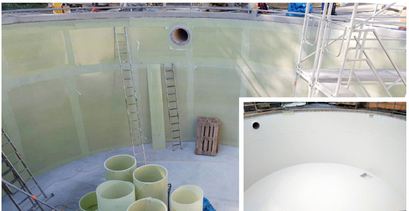
Sickerwasserbecken aus Beton (5 m hoch und 11 m im Durchmesser; Stärke des Noppenlaminats 3 mm )
