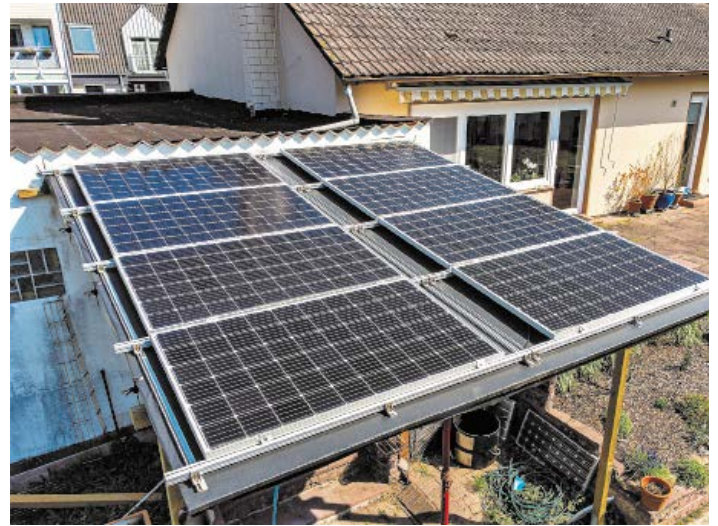
Bild 4 • Die Solarstromanlage auf dem Vordach produziert rund 2.500 Kilowattstunden pro Jahr und soll demnächst erweitert werden.
