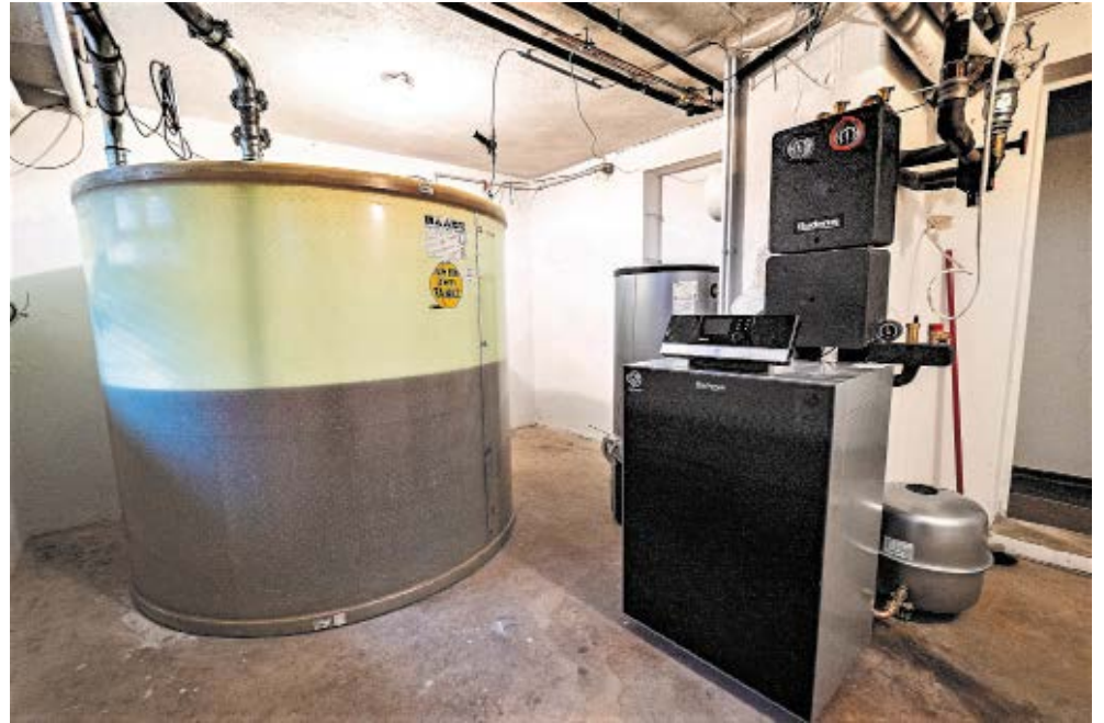
Bild 5 • Nach der Modernisierung: Die neue Heizung und der neue Tank helfen zukünftig beim Sparen: Laufende Kosten und Treibhausgasemissionen werden reduziert.
